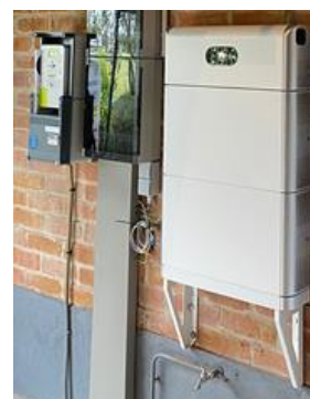
Huawei-omvormer en -thuisbatterijen (10 kWh) (MR Solar)
